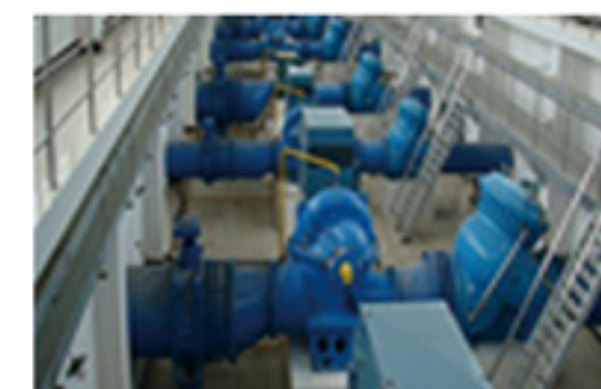
Pump and fan
